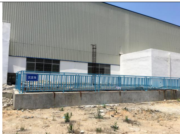
二级过滤沉淀池
